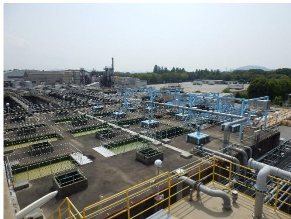
⑧給・排水間が圧巻です。
